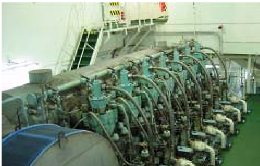
图表 3 Loch Rannoch 工程的预测维护系统监测引擎室内的泵和马达的工作状态。这些机械设备被安装了大约 150 个加速度器。加速度器探测出的震动数据用于评估当前的操作环境。当磨损或撕裂现象出现时，则无线传感器网络中的 Mote 和网关通过无线通信发送警告。
